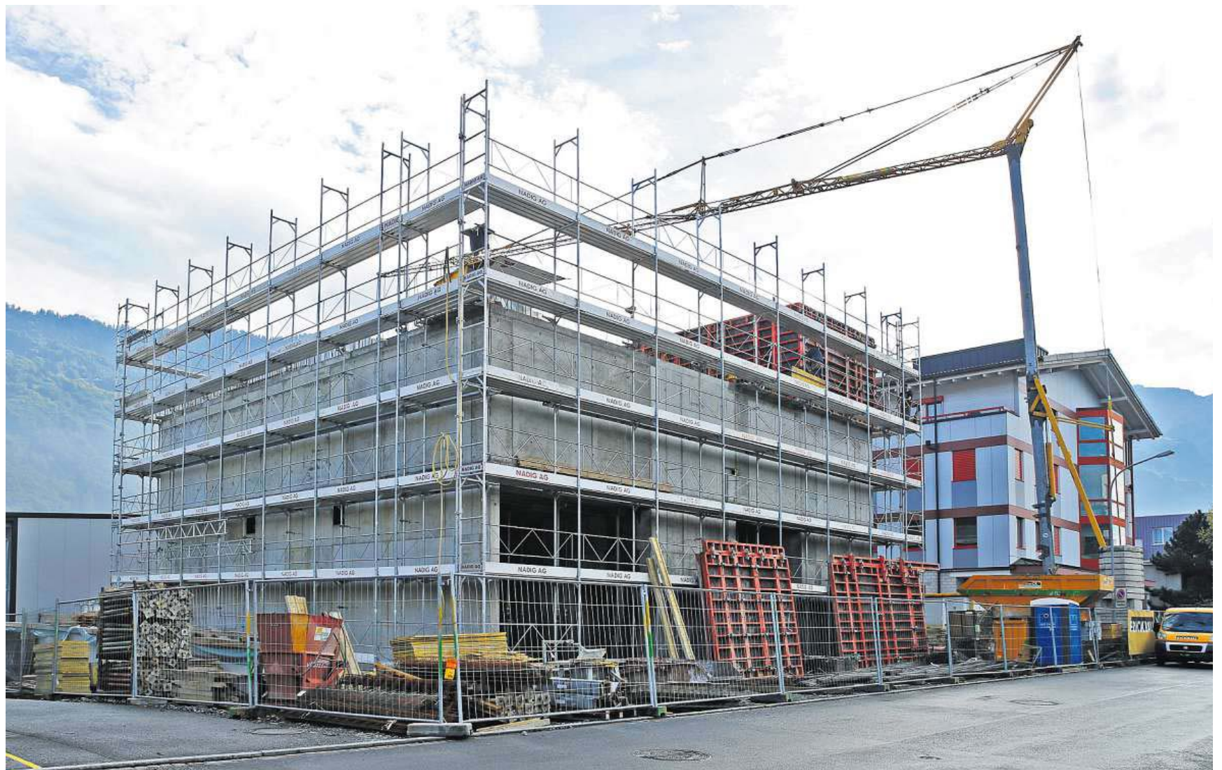
Neues Geschäftsfeld: Im Industriegebiet von Triesen entsteht ein fünfstöckiges Hochsicherheits-Lagerhaus für Edelmetalle oder Kunstgemälde.
